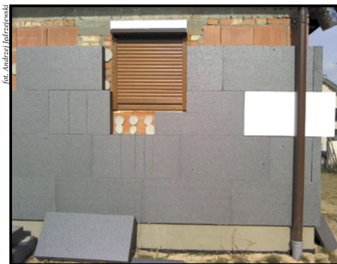
Fot. 2. Miejsce obserwacji na ścianie z odspojonym styropianem grafitowym i jedną, przyłożoną dla porównania płytą styropianu białego
