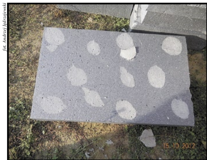
Fot. 1. Odpadnięta płyta styropianu grafitowego. Widoczne miejsca po odspojeniu oraz doskonale przyczepny skrawek kleju
