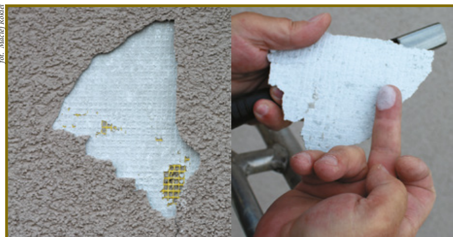
Fot. 11. Zła przyczepność tynku elewacyjnego na skutek braku odpowiedniego przygotowania podłoża
