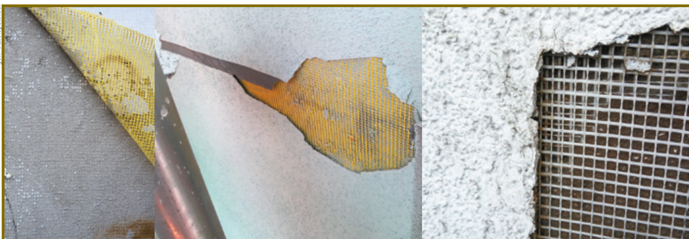
Fot. 8-10. Rezultat błędów w wykonaniu warstwy zbrojącej
