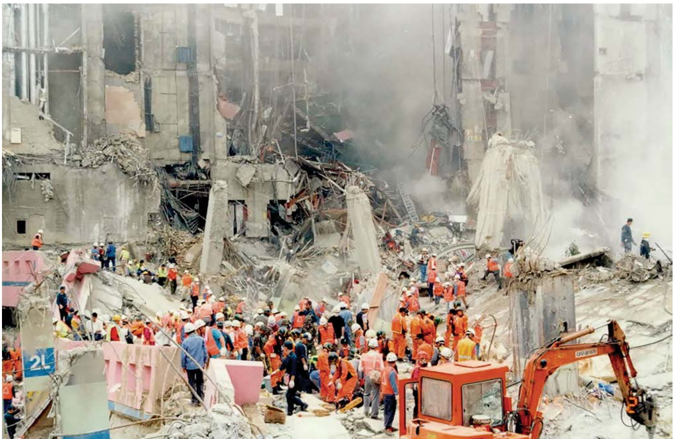
Zawalenie się centrum handlowego w Seulu
