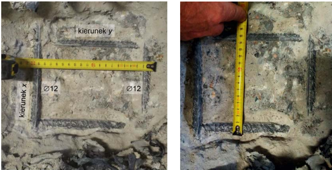
Rys. 5. Rozstaw zbrojenia górnego stropu nad garażem
