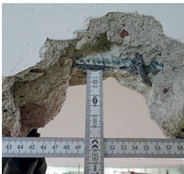
Rys. 5. Zbrojenie zlokalizowane w odkrywce O1
