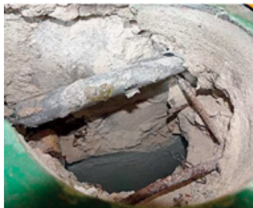
Rys. 9. Odkrywka posadzki przy słupie z widocznym zbrojeniem w nadbetonie
